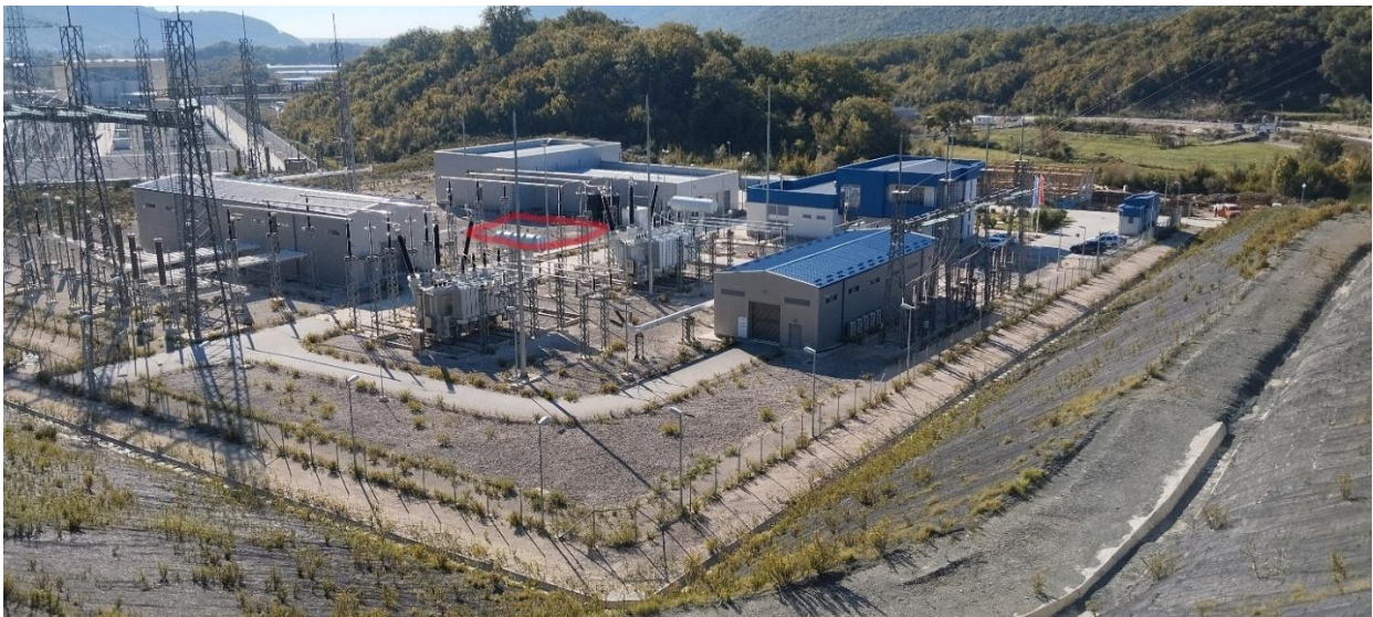
Slika 3. Lokacija ugradnje varijabilnog šant reaktora u TS 400/110/35 kV Lastva Grbaljska
